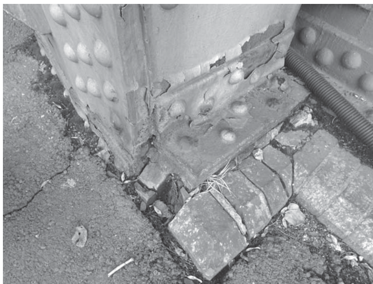
Das denkmalgeschützte Gerüst rostet seit Jahren.
